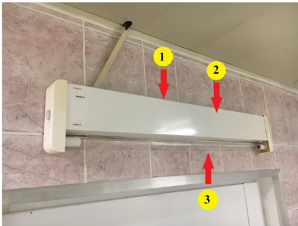
Ультрафиолетовая бактерицидная установка ОБН-150: 1 – УФ лампа №1; 2 – защитный экран; 3 – УФ лампа №2
